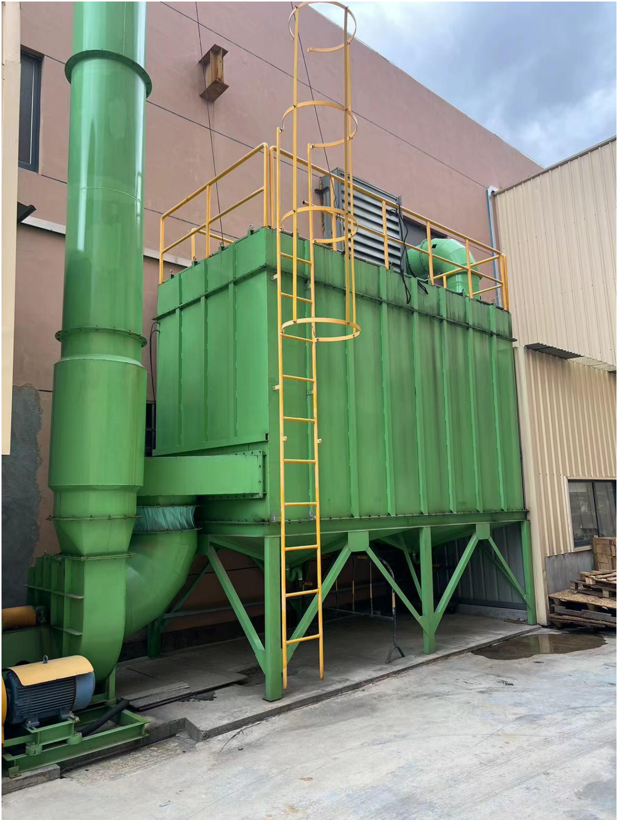
挤塑废气处理设施
