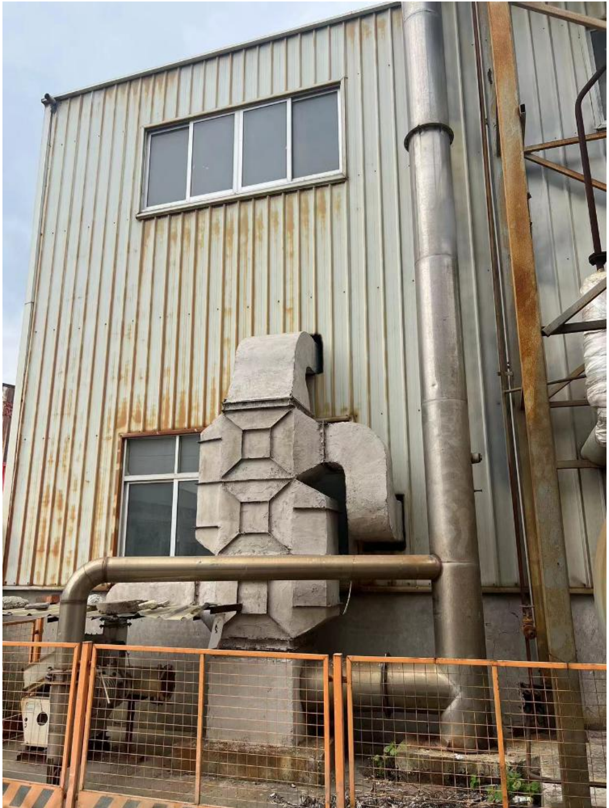
锅炉废气排气筒
