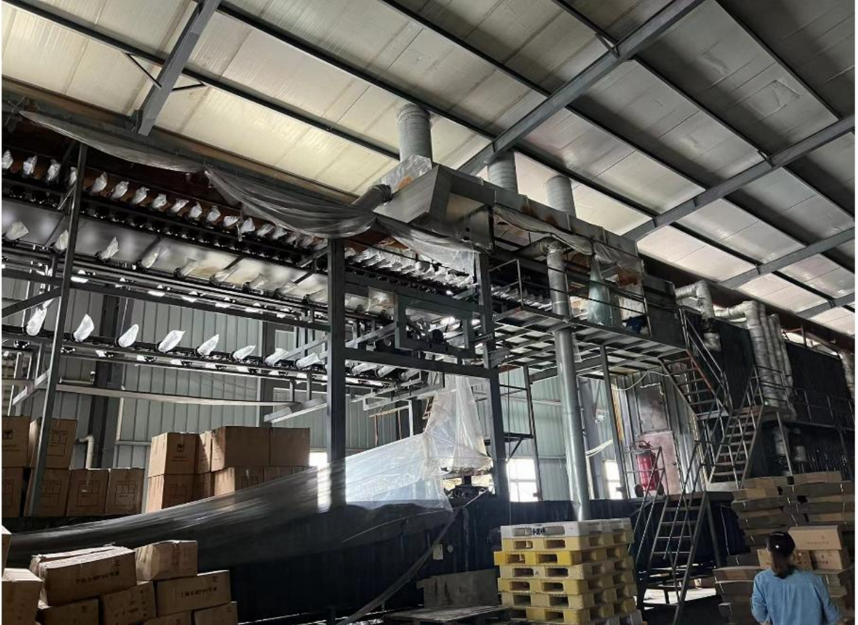
烘干废气管道收集
