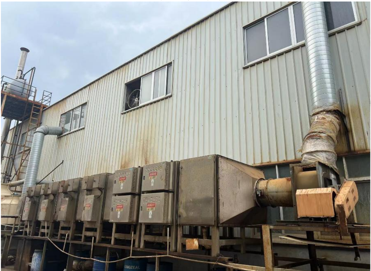
烘干废气处理设施
