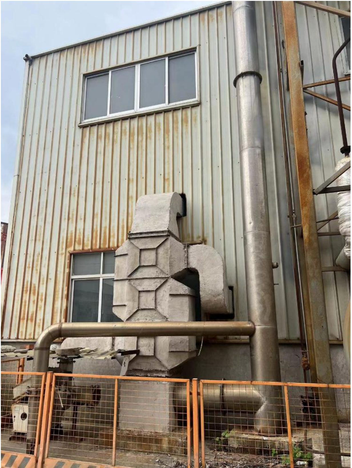
锅炉废气排气筒
