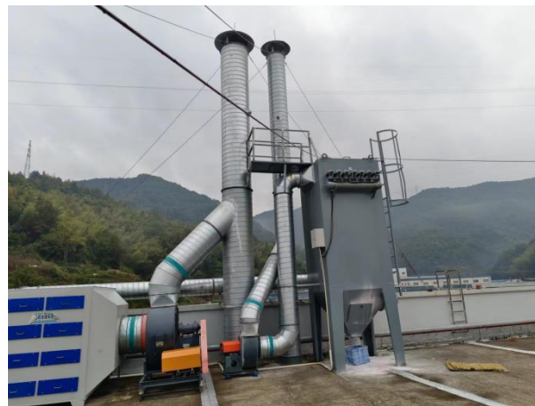
布袋除尘器、废气排放口
