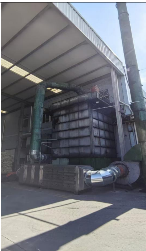
造粒、挤出、复合废气处理设施
