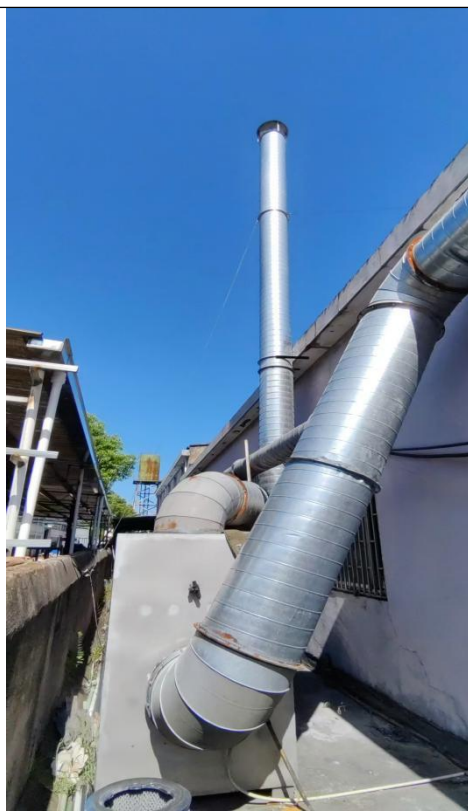
打粉废气处理设施
