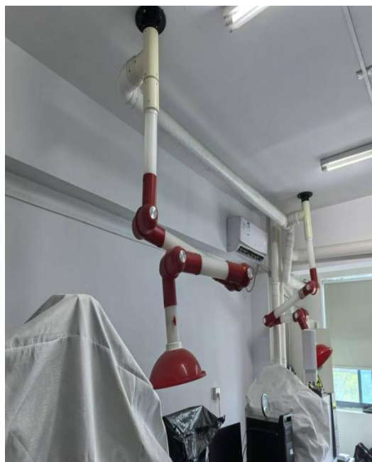
废气收集装置
