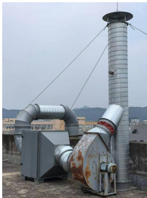
废气处理设施
