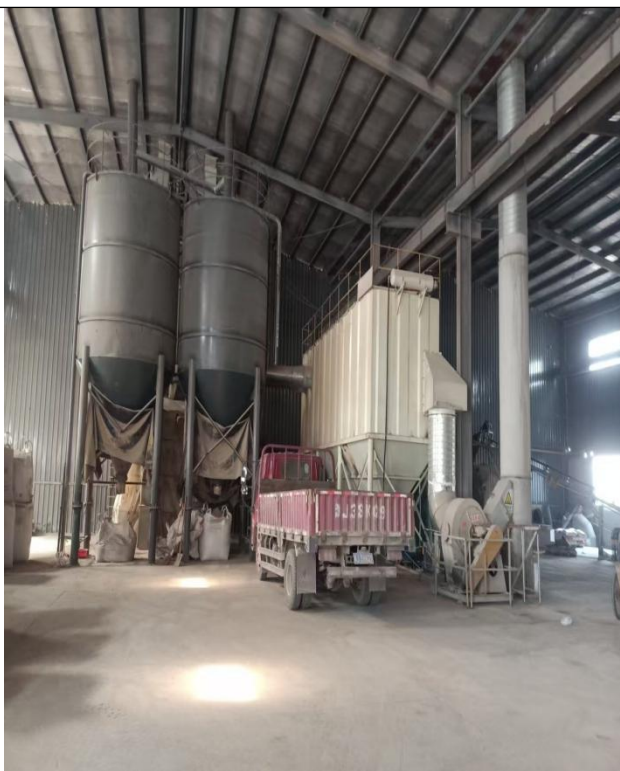
废气处理设施
